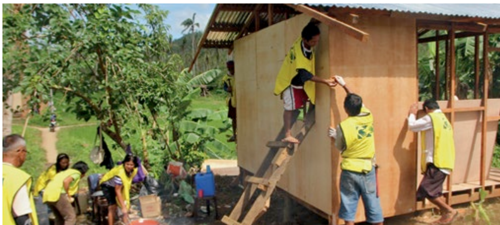
Los voluntarios clavan madera contrachapada en la estructura de una casa nueva en Tacloban, Filipinas.
